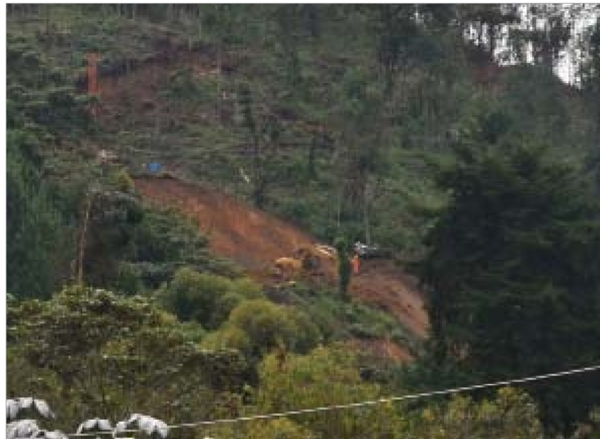
Lamáquina 'barriendo' el material en el sitio. Abajo, la retroexcavadora acumulando el material para evacuar el lugar.
