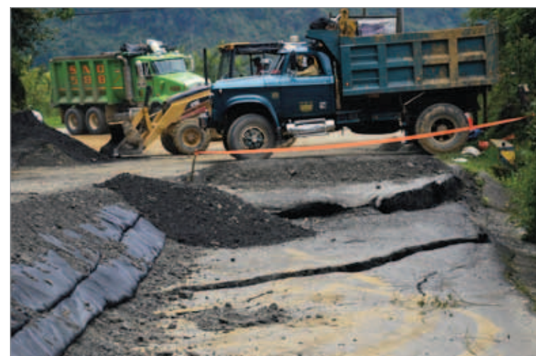
Daños en el 6 más 300, que están igual.
