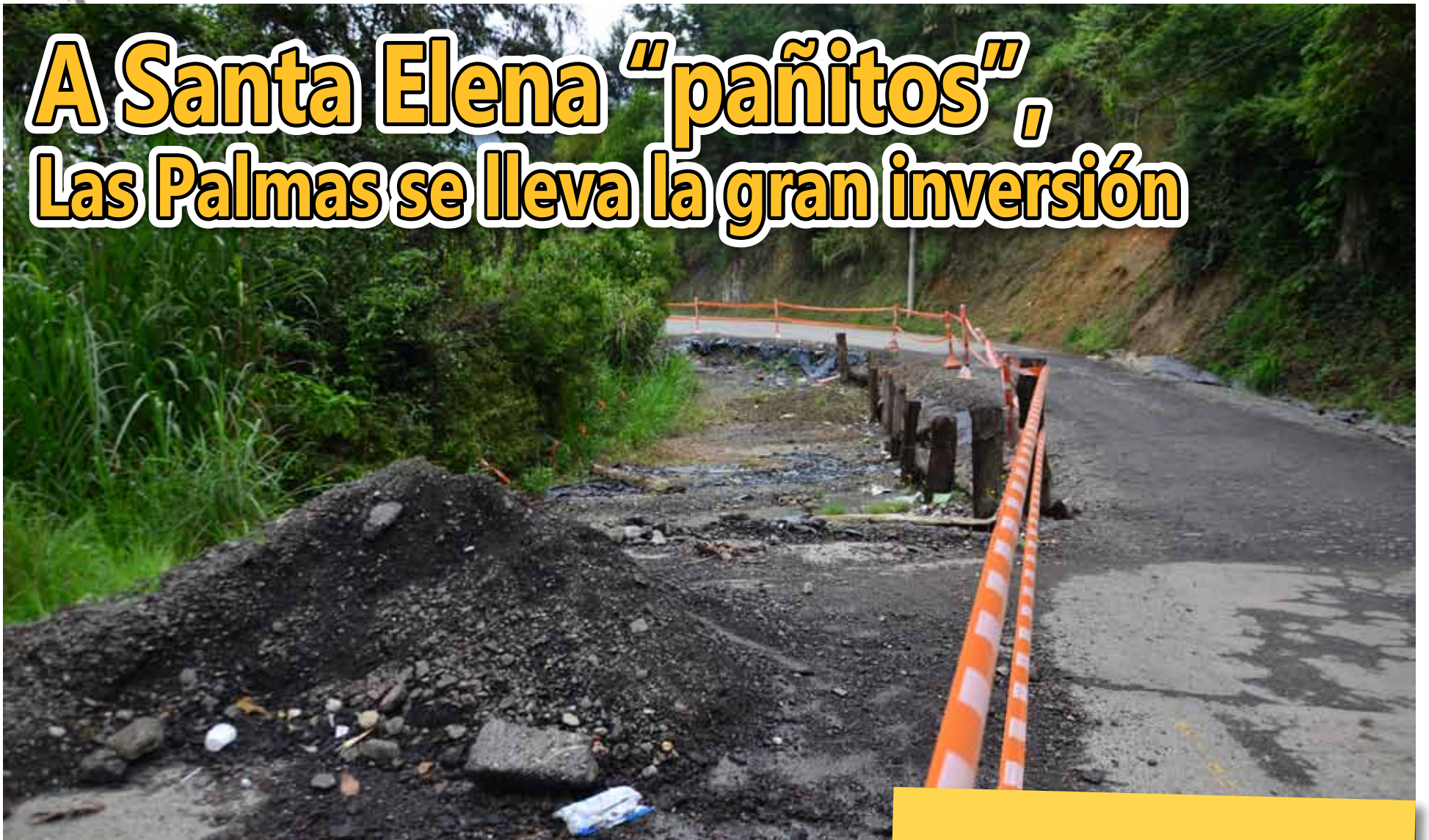
Aunque por estos días parece que fueran a iniciar un llenado porque hay afirmado en la vía dispuesto para ello, en el kilómetro 6 más 300 el asunto no mejora y cada vez se hunde más. Es el punto más crítico que tiene toda la vía.
