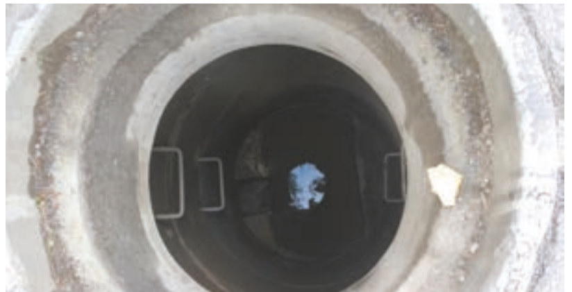
El manhole de la evidencia. El día que se tomaron estas fotos, las aguas residuales caían directamente a la Quebrada Santa Elena. Foto tomada el 16 de agosto.
