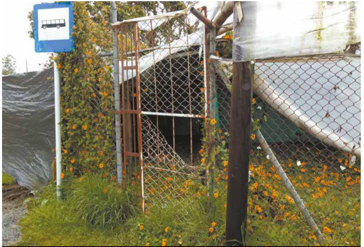
Este lugar está abandonado hace varios meses, tal vez años. Nótese cómo la planta invadió el espacio. Se descuidan y empieza a tumbar paredes.
